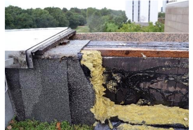
Attika, Stahlbeton mit Bitumen verunreinigt
