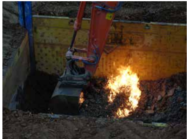
Abb. 10: Brand während Nassaushub.
