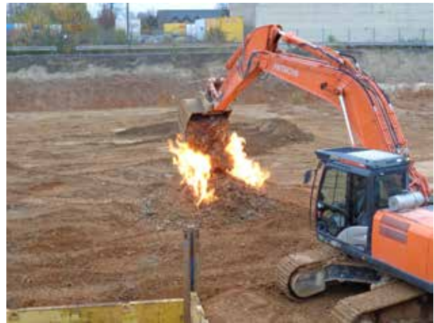
Abb. 9: Selbstentzündung während dem Nassaushub.
