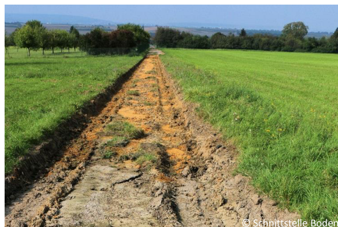
Entsigelter Wirtschaftsweg vor Herstellung einer durchwurzelbaren Bodenschicht
