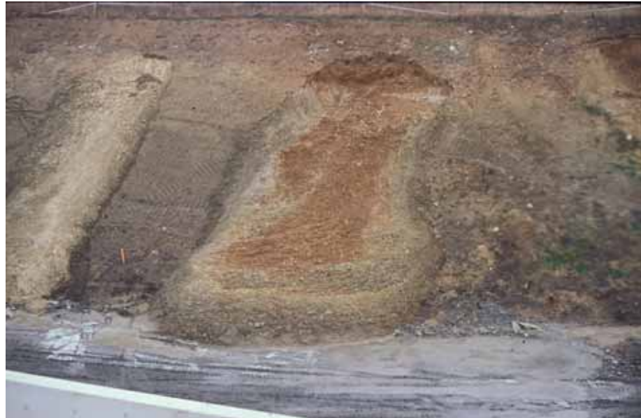
Abb. 8. Ausfließender Mergel in der ICE-Trasse bei Wallau. Der Mergelbrei fließt zungenförmig über das bereits betonierte Gleisbett hinweg. Über dem grauen Mergel liegt rostfarbiger kaltzeitlicher Kies, in dem sich Grundwasser sammelt, das den Mergel vernässt und ausfließen lässt.
