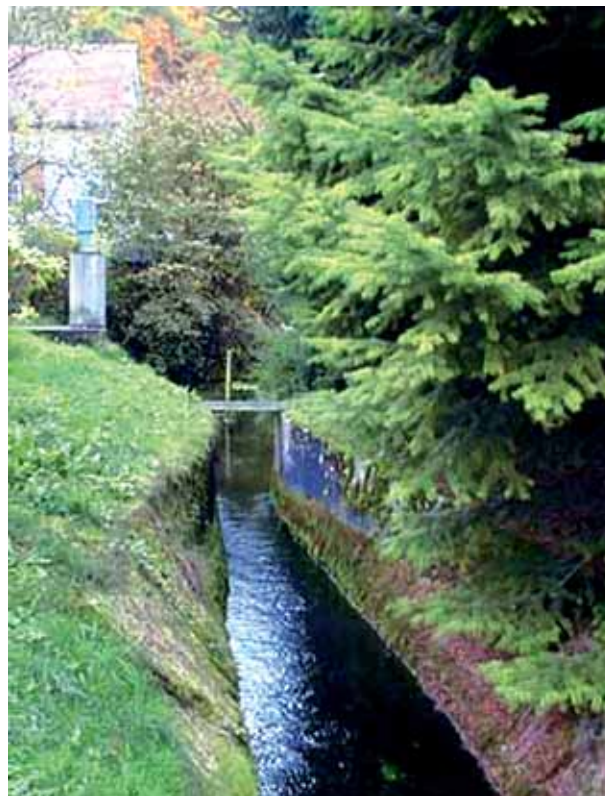
Abb. 2: Venturigerinne in der Nähe des Austritts der Kressenteichquelle 410503 Breitau; zu sehen sind der Überfall, die Pegellatte und der Vertikalschreiber zur kontinuierlichen Erfassung des Wasserstandes.
