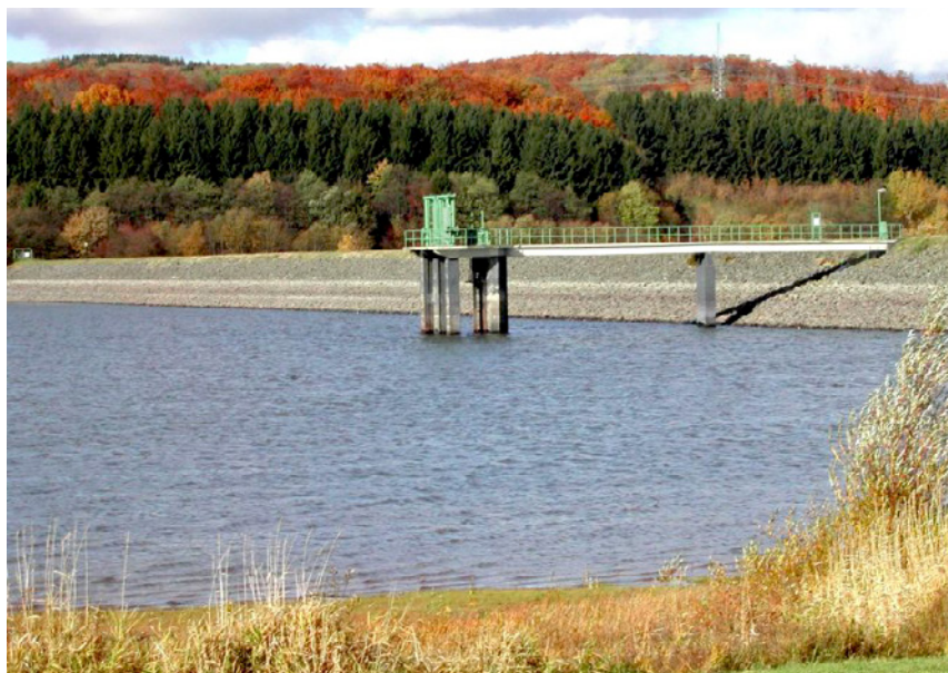
Abb. 1: Absperrbauwerk der Krombachtalsperre, Blatt 5314 Rennerod. Sichtbar sind das Absperrbauwerk und ein Teil des Beckenraumes.
