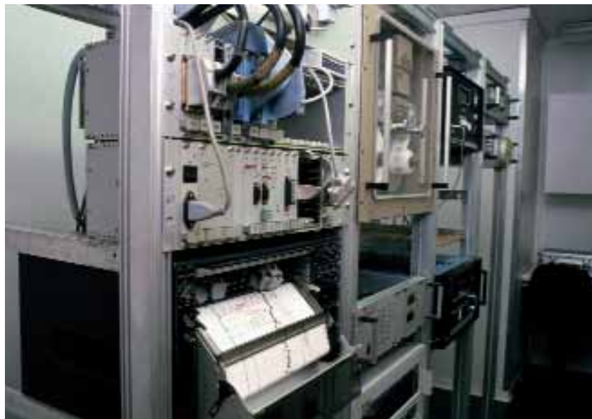
Abb. 3: Blick in eine Luftmessstation.
