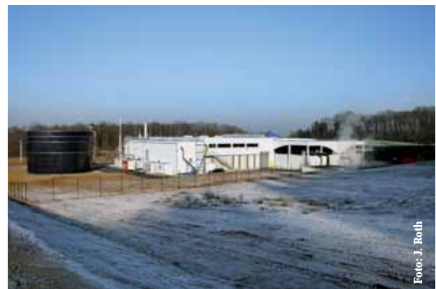
Abb. 2: Vergärungsanlage mit Gärrestbehälter.
