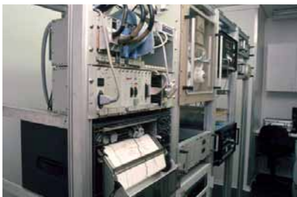
Abb. 2: Blick in das technische Innenleben einer Luftmessstation.
