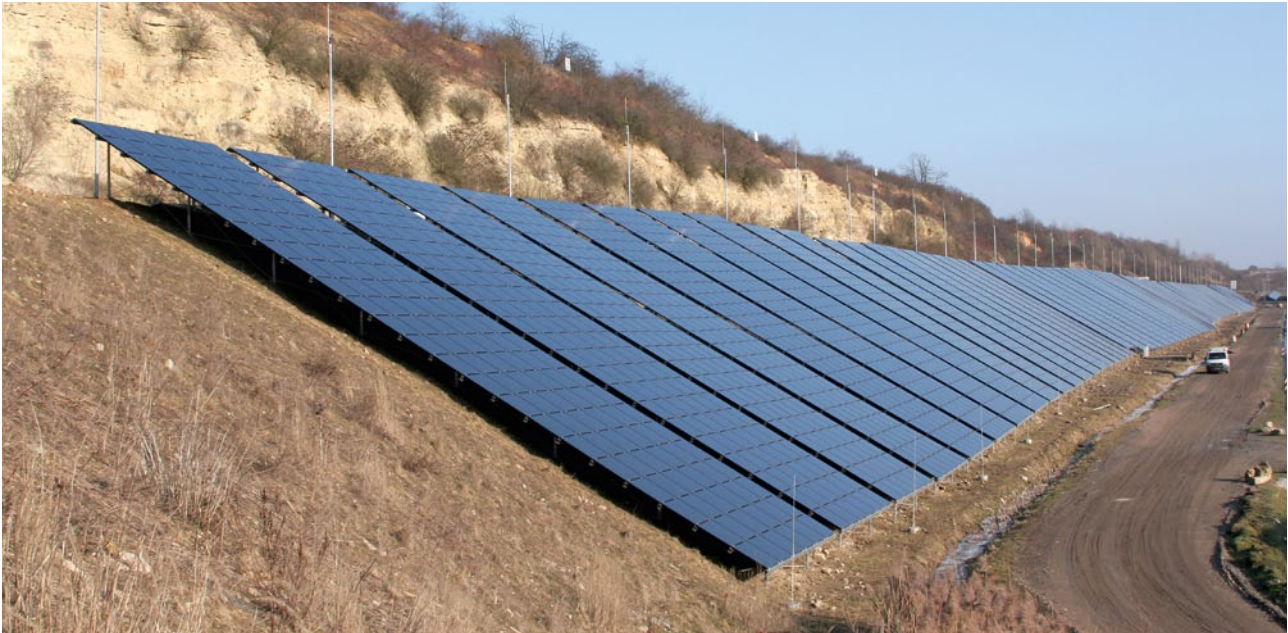
Abb. 1: Fotovoltaik-Freiflächenanlage auf dem Gelände des Dyckerhoffbruchs in Wiesbaden. (Foto: ELW Entsorgungsbetriebe der Landeshauptstadt Wiesbaden, Frank Fischer.)
