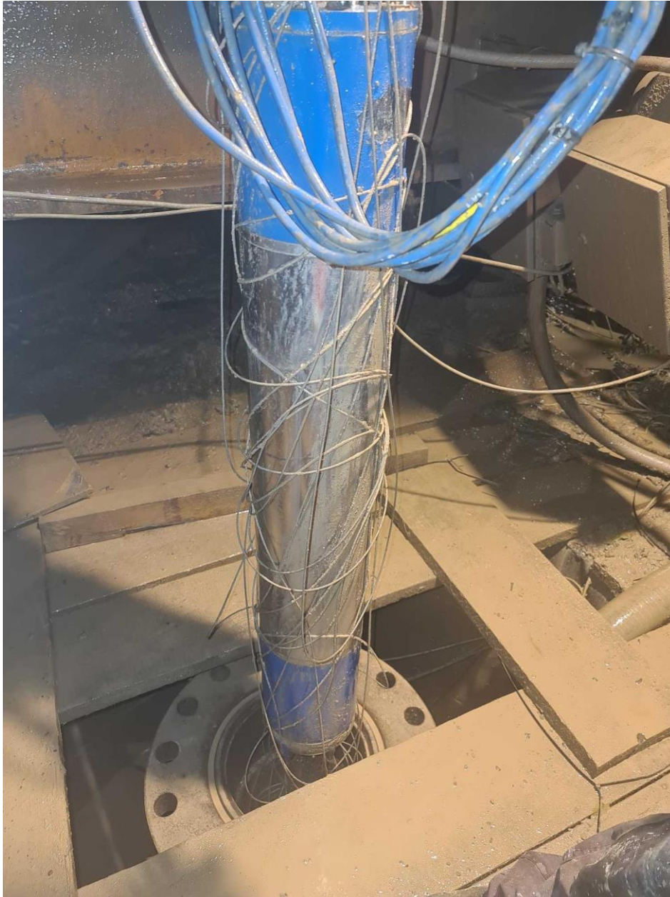
Abb. 9: Tauchpumpe mit Drahtseil, das sich um die Pumpe gelegt hat (Foto: Rumohr)
