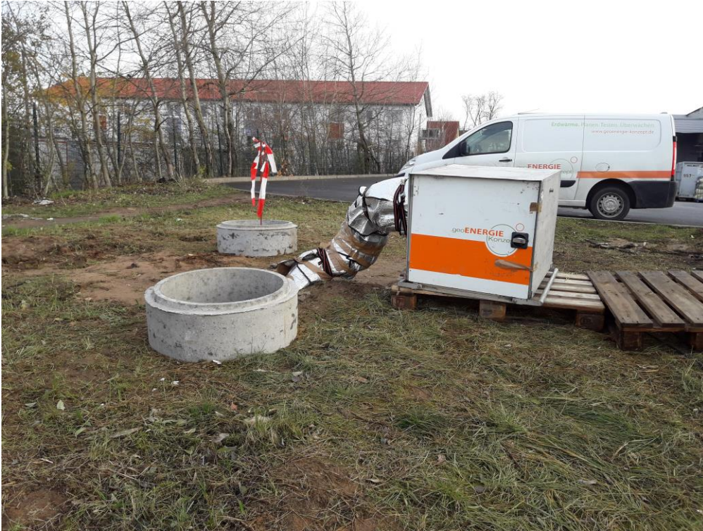
Abb. 2: aufgebautes Testgerät am Standort
