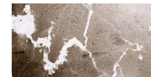
Baustoff nach 2 Frost-Tau-Zyklen
