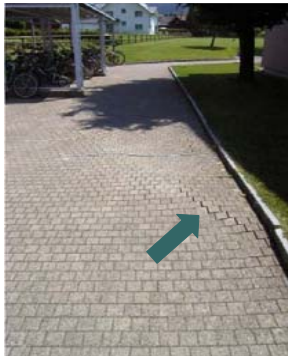
Frosthebungen über den Zuleitungen
