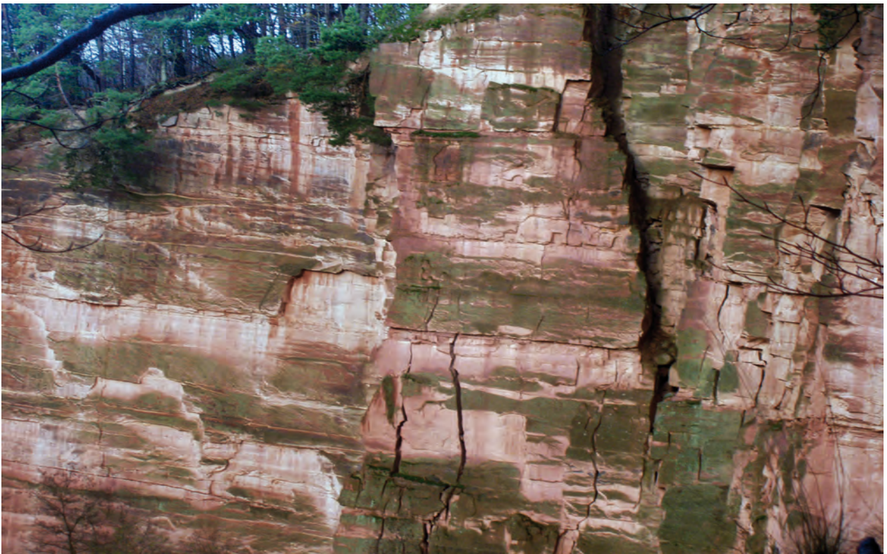
Weit geöffnete Klüfte im ehemaligen Steinbruch zeigen, dass das Gebirge stark aufgelockert ist und Steinschlag oder Felssturz droht.
