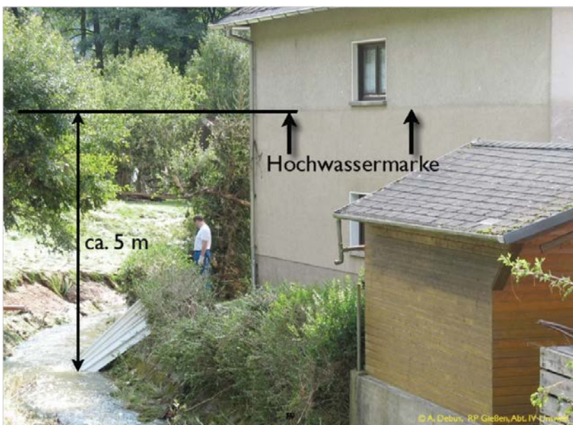
◀ Folgen des Starkregenereignis vom 17. September 2006: Die Abbildung zeigt die Hochwassermarke an einem Haus in Haiger-Sechshelden am Kuhbach am Tag darauf. Lokal traten bis dahin nicht vorstellbare Überflutungshöhen und große Schäden auf.
