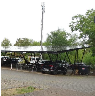
Abbildung 13: PV-Anlagen über einer Parkplatzfläche
