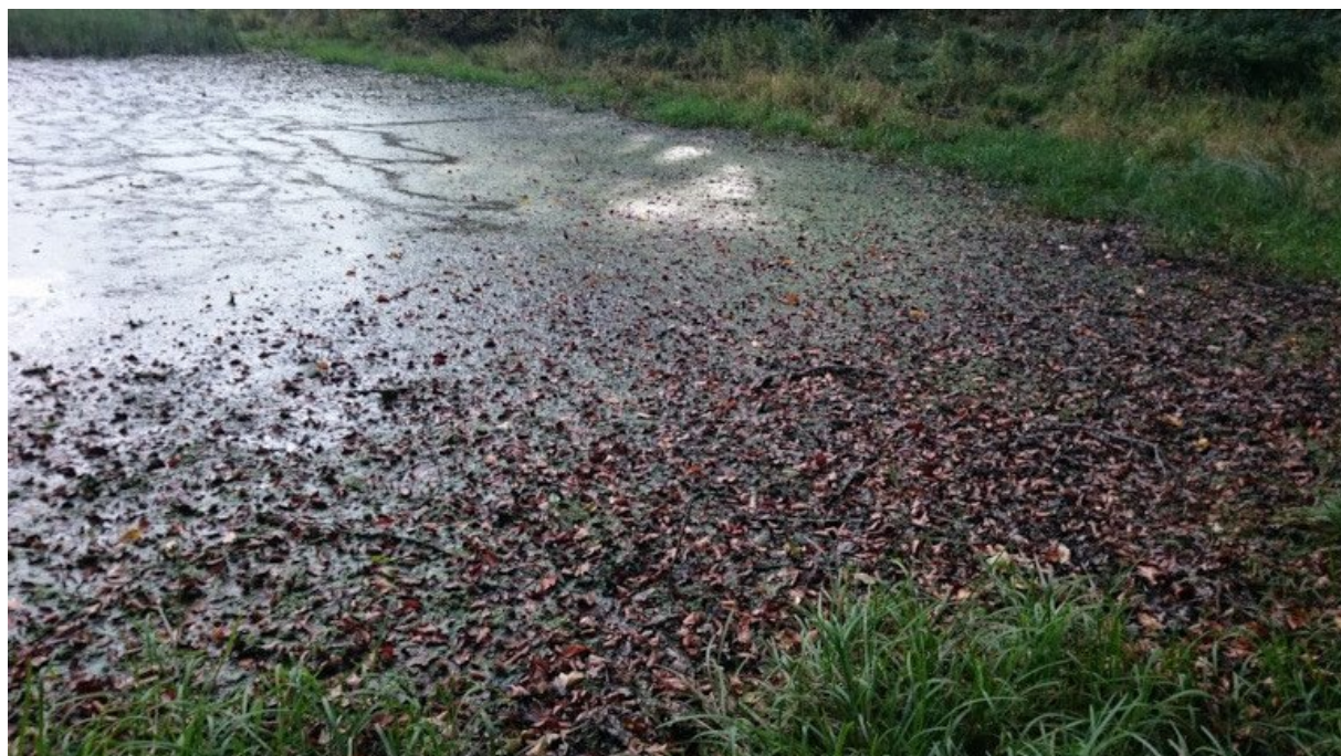
Abbildung 143: Stark verschlammte Bereiche
