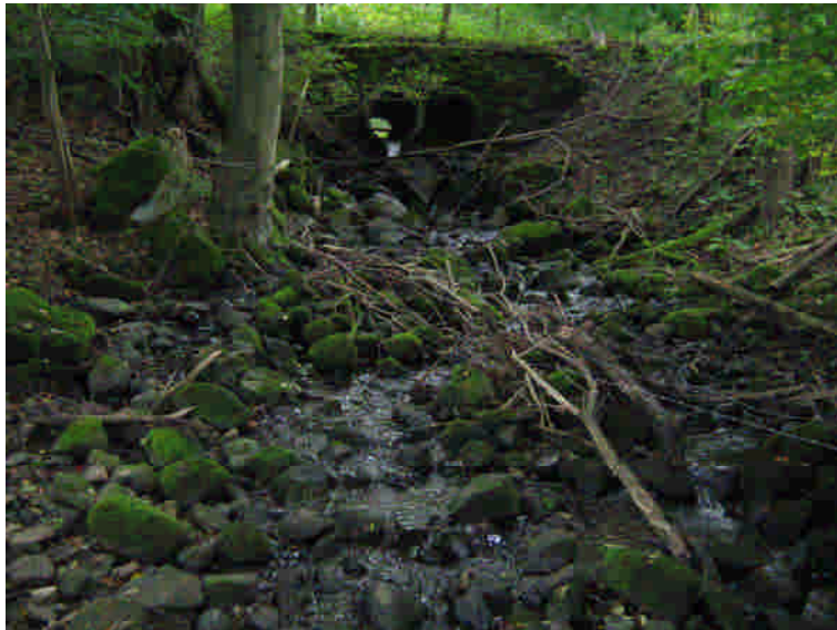
Abbildung 24: In freiem Überfall endende Wegedurchlassverrohrungen sind für Fische Bach aufwärts nicht oder kaum passierbar; so fanden sich an PS 23 Bachforellen ausschließlich unterhalb der Verrohrung
