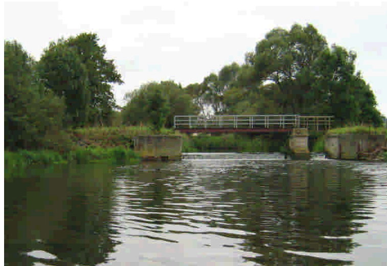
Abbildung 7: Das Wehr in der Ulster bei Philippsthal stellt augenscheinlich eine Barriere für aufwanderungswillige Fische dar
