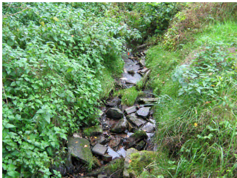
Abbildung 13: Neben Natursteinen fand auch Bauschutt Verwendung, um Uferböschungen und Gewässersohle des Mansbaches streckenweise zu befestigen
