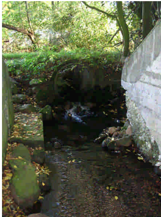
Abbildung 43: Das Herrenwasser im Bereich des in Betonmauern gefassten Durchlasses einer nicht mehr in Nutzung befindlichen Bahntrasse
