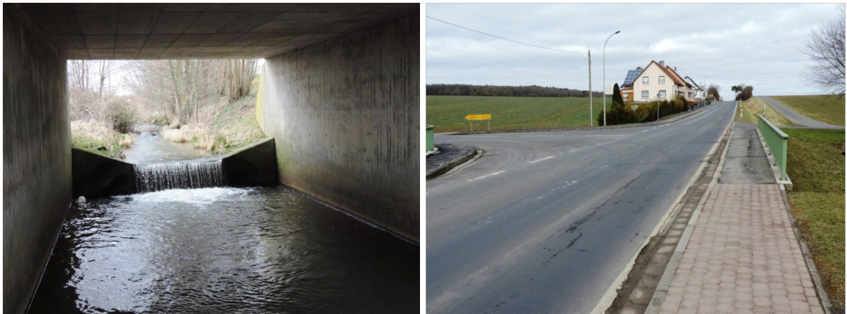
Abb. 33: Links - eine Sohlschwelle unter einer Brücke über den Erlenbach bei Münch-Leusel zwingt Otter über die dort besonders gefährliche Straße L3156 zu laufen; rechtes Bild: der Verlauf der L3156 im Bereich der Brücke über den Erlenbach – das Risiko einer Kollision zwischen Fischotter und KFZ ist hier besonders hoch.
