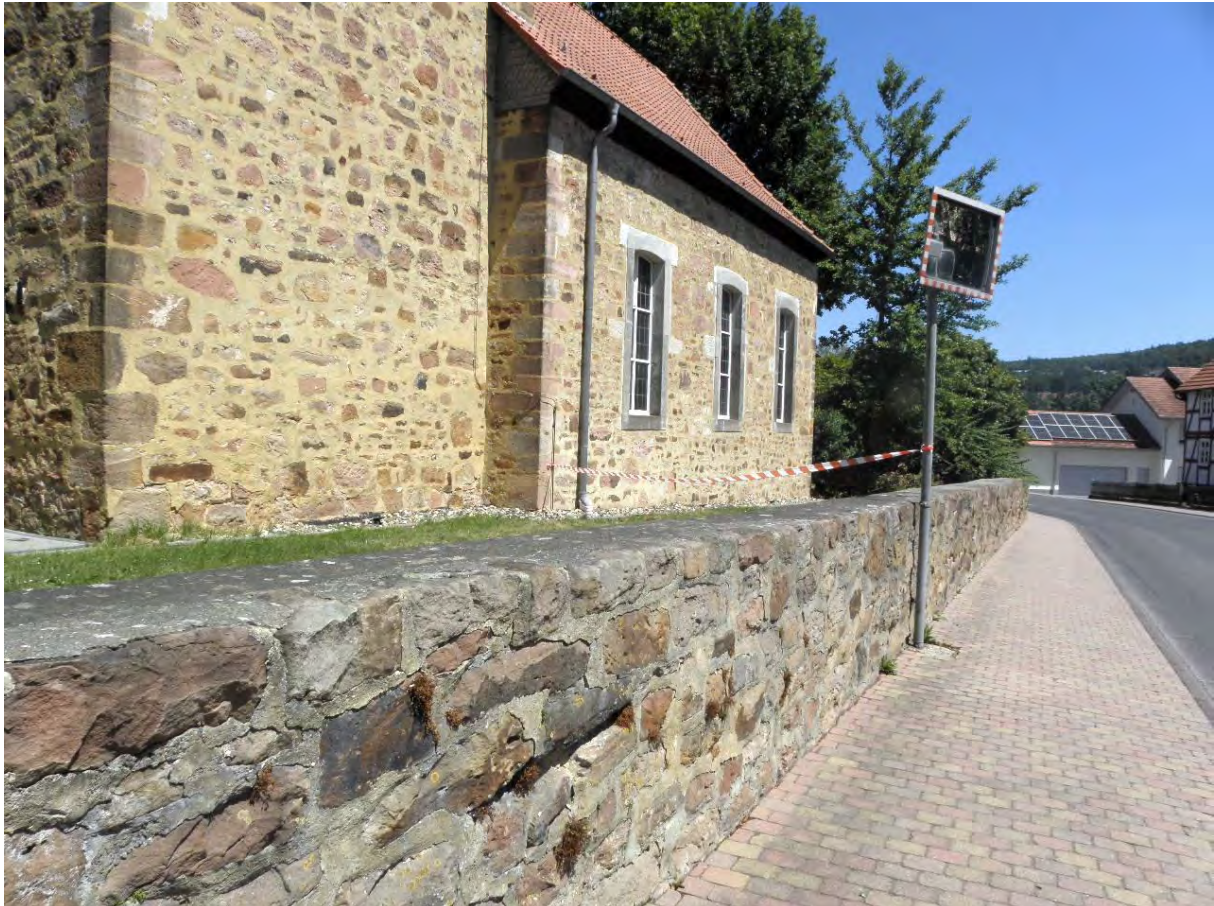
Abb. 3.01.1: Bereich 1 (07.07.2023). Die Mauern der Kirche und die Umgrenzungsmauer sind wichtige Nistplätze. Hier inspizierte u.a. die Goldwespe Chrysis iris Hohlräume.
