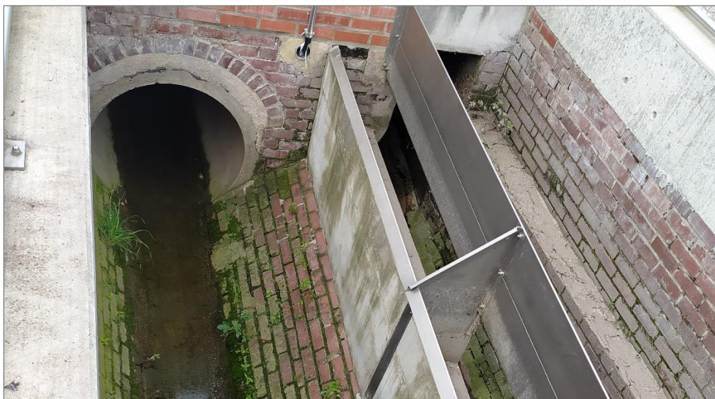
Abb. 5: Mischwasserentlastungsanlage im Kanalnetz der Kläranlage Bickenbach (Foto: HLNUG, Wiesbaden)
