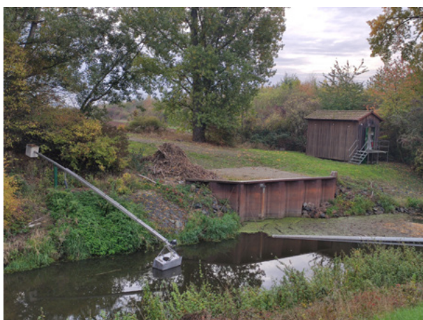
Abb. 13: Gewässergüte-Messstation mit Pumpenausleger Ginsheim, Schwarzbach © HLNUG
