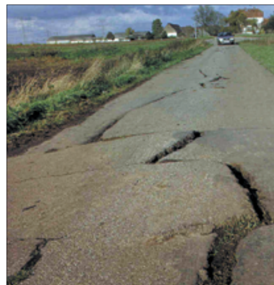
Setzungsschäden an einem landwirtschaftlichen Weg
