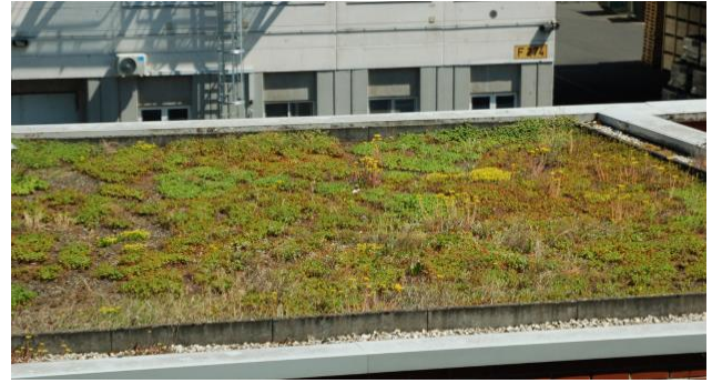
Abbildung 35: Extensive Dachbegrünung mit Retentionsdach-Wasserspeicher (Foto: HLNUG, A. Sander).
