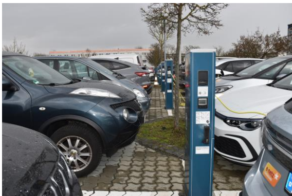
Abbildung 21: Beispiel von E-Ladesäulen (Foto: e-netz Süd Hessen AG).
