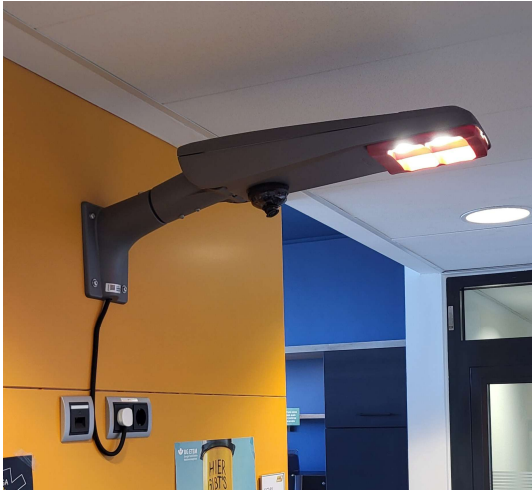
Abbildung 45: Beispiel einer modernen LED-Strassenbeleuchtung (Foto: e-netz Süd Hessen AG).
