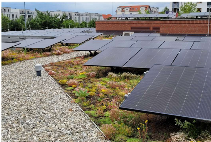
Abbildung 25: Extensive Dachbegrünung mit aufgeständerter PV-Anlage - Capitol Dietzenbach (Foto: HLNUG, J. Kuckuk)
