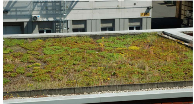
Abbildung 28: Extensive Dachbegrünung mit Retentionsdach-Wasserspeicher (Foto: HLNUG, A. Sander)
