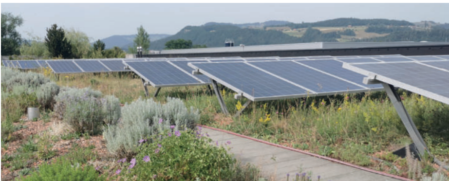
Abb. 45: Industrie Gründach mit Solaranlage, Thun/Schweiz (HLNUG; GRÜNSTATTGRAU, Gruchmann)
