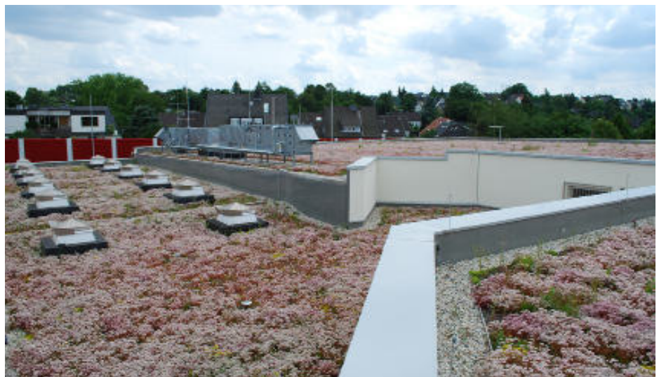
Abb. 42: Retentionsdach, Wasserwerke Bochum (HLNUG; Optigrün International AG)
