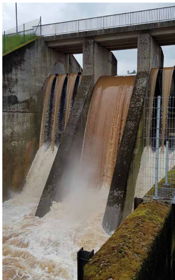
Abb. 33: Wasserabgabe der Kinzigtalsperre über alle drei Wehrfelder im Mai 2019 © Wasserverband Kinzig
